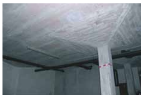
Következmény: Hatalmas energiavesztés, és komfort nélküli lakóhelység. A hideg alagsor feletti fűtött helységben párázás és penész látható.
